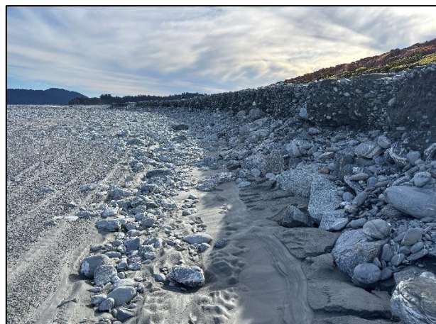
(d) Erosion along Havill's Wall.
